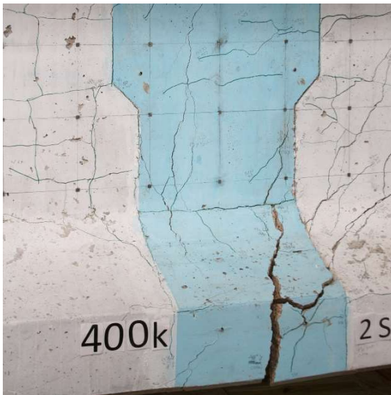
(d) Failure at Splice 2 ( P = 1780 \text{ kN} = 400 \text{ k} )
